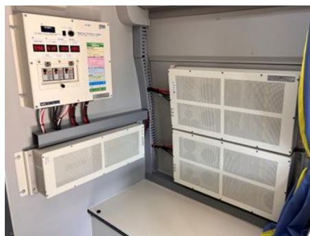
【蓄電池システム】
